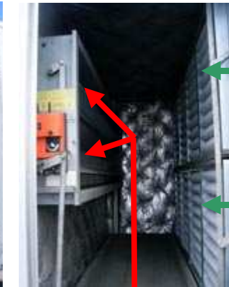
(Volet d'ouverture d'air neuf et filtre a air)
